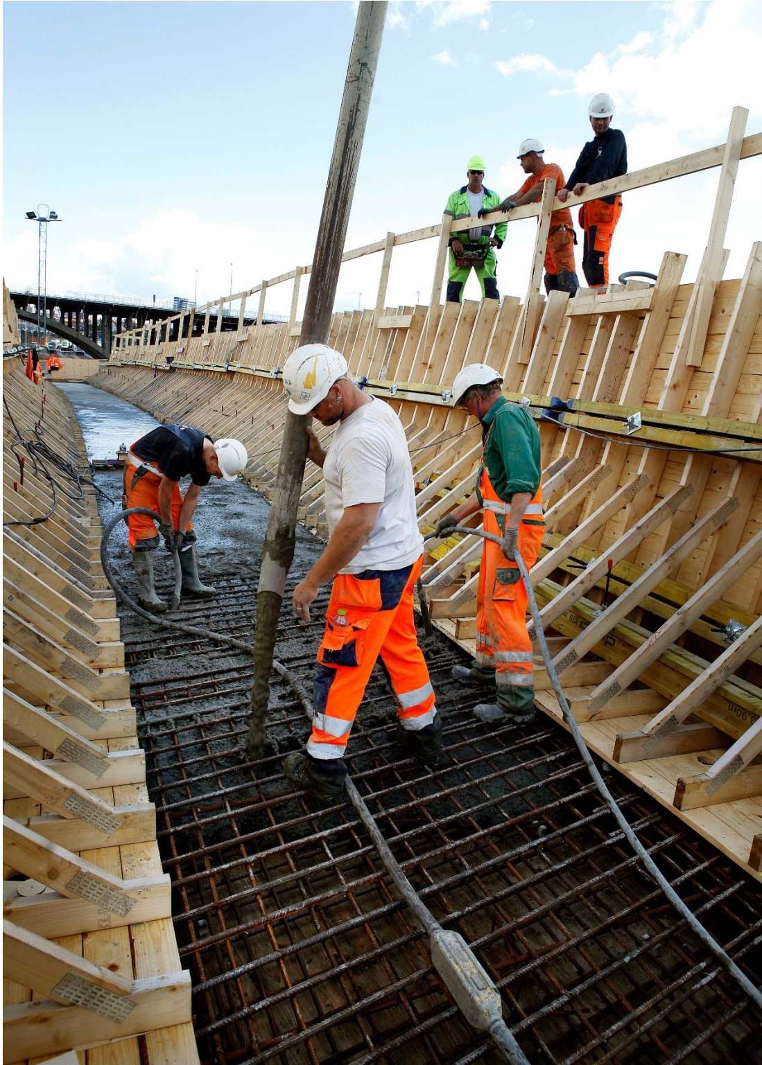
Sidst i august blev brodækket til broen over banegraven støbt. Det krævede 11 mand, otte betonlastbiler og to betonpumper at fordele de 2.160 tons beton til betondækket på den 125 meter lange bro.
