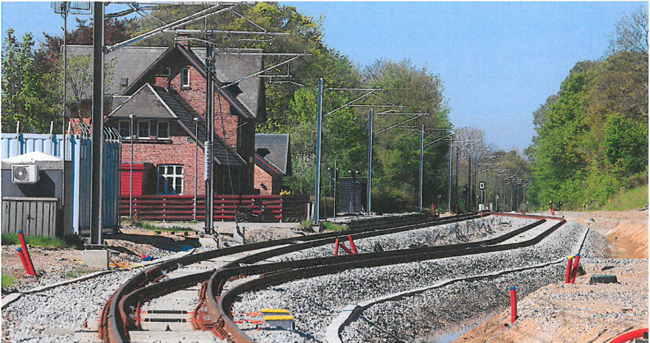
Krydsningssporet her ved Trustrup Station gør det muligt at øge antallet af afgange mellem Aarhus og Ryomgård. Chili Foto.
