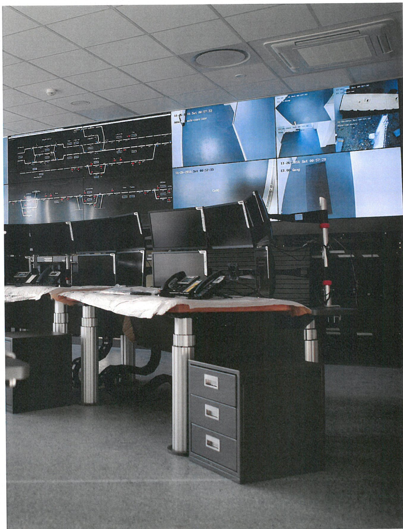
Midt i november 2016 flyttede Aarhus Letbane ind i det nye Trafik- og Servicecenter i banegraven. Ud over kontrolrummet her på billedet, indeholder centeret værksted, depot, vaskehal, opstillingsområde og kontorer. Chili Foto.
