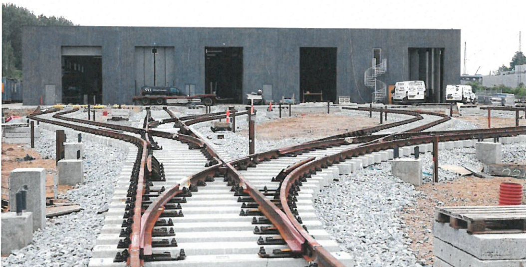
Byggeriet af letbanens Trafik- og Servicecenter i Banegraven skrider frem efter planen. I andet kvartal blev der bl.a. lagt skinner og rammet fundamenter til kørestrømsmaster på det 27.000 m 2 store areal. Jens Hasse/Chili Foto
