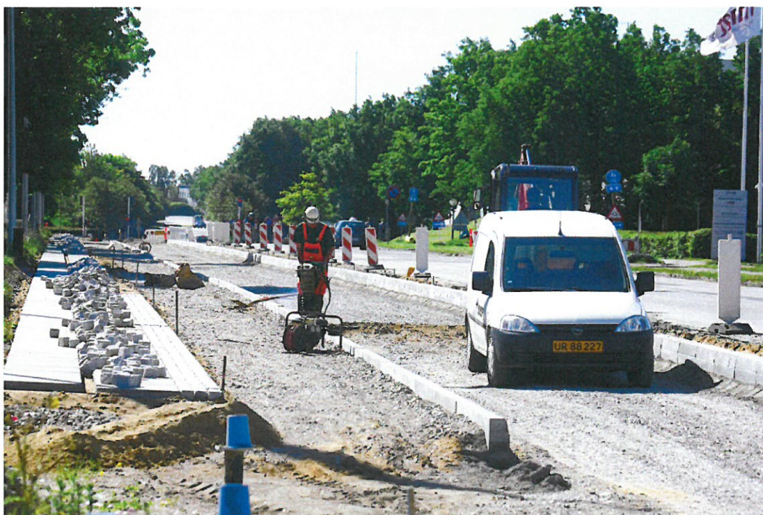
Olof Palmes Allé udvides med nyt fortov, cykelsti og vejbane, inden anlægsarbejdet til Letbanen kan gå i gang i den nuværende vejbane. Det forberedende anlægsarbejde fortsætter året ud, hvor ASAL-konsortiet overtager og etablerer transportsystemet.
